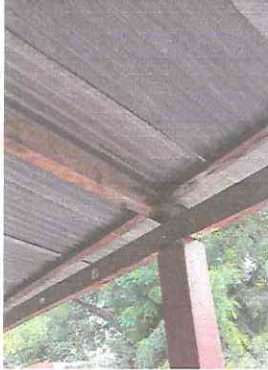
Foto 1: Necesidad de cambio de estructura y lámina de dos aulas
