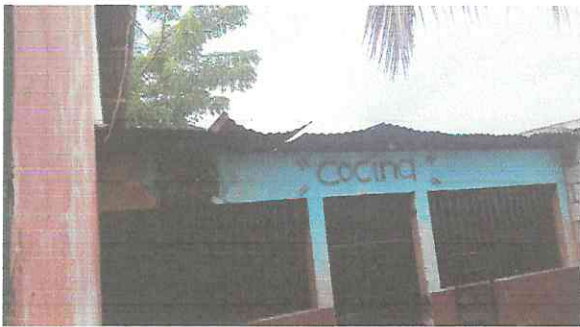
Foto 3. Necesidad de cambio de estructura y lamina de cocina.
