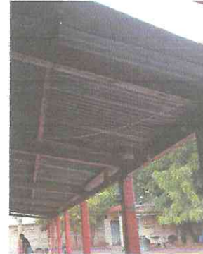
Foto 2: Necesidad de cambio de estructura y lámina de dos aulas
